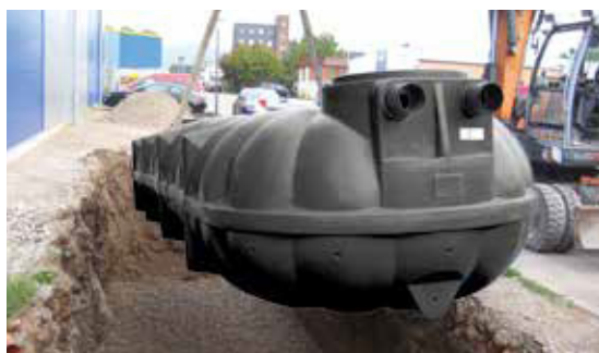
Installasjon NEO infiltrasjonstank 10 000 l
